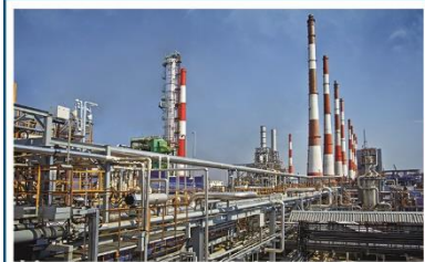
Регуляторы давления газа в составе ГРП для Астраханского ГПС
